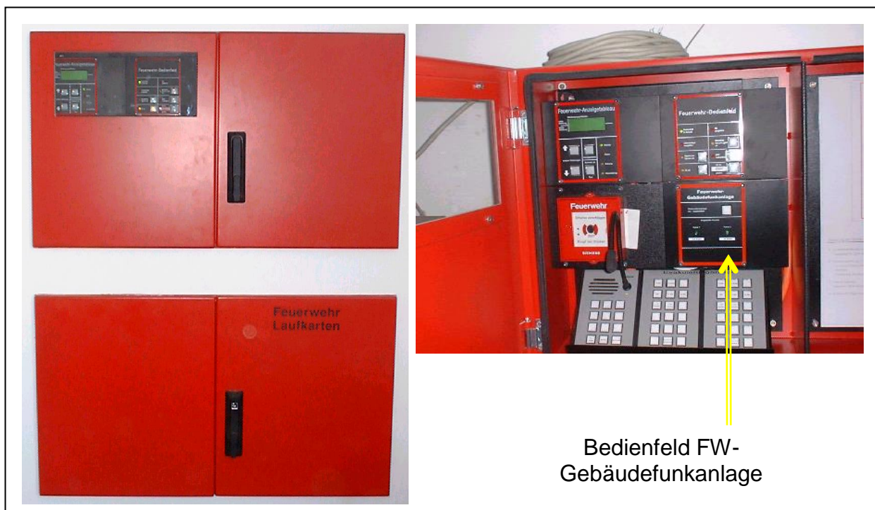
Abbildung 1: Bsp. FW-Gebäudefunkbedienfeld in einem FW-Anlaufpunkt einer BMA
