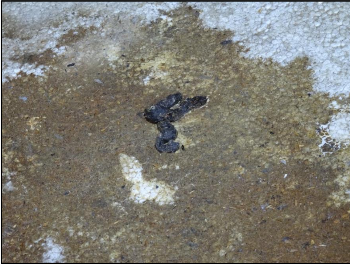
Bild 25: Marderkot Dachboden Wohnhaus 1
