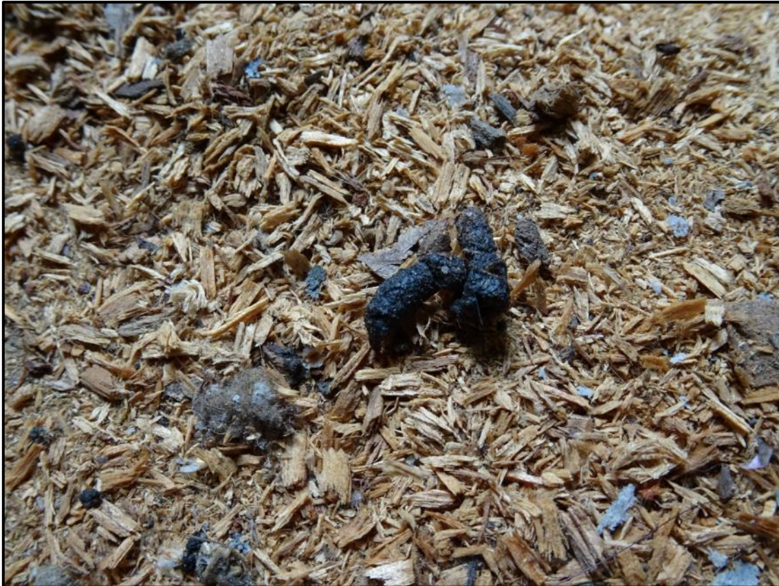
Bild 24: Fledermauskot Dachboden Wohnhaus 1
