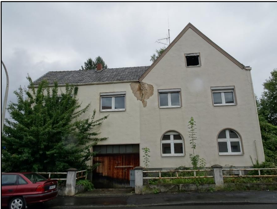
Bild 12: Frontansicht Wohnhaus 2 mit Fassadenschaden
